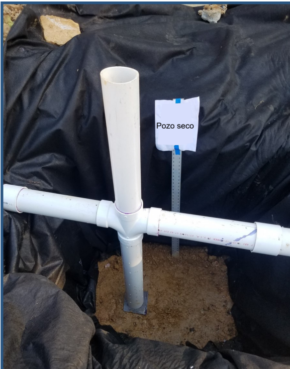
Foto con tela filtrante instalada en los laterales, placa de anclaje y tubo de PVC perforado
